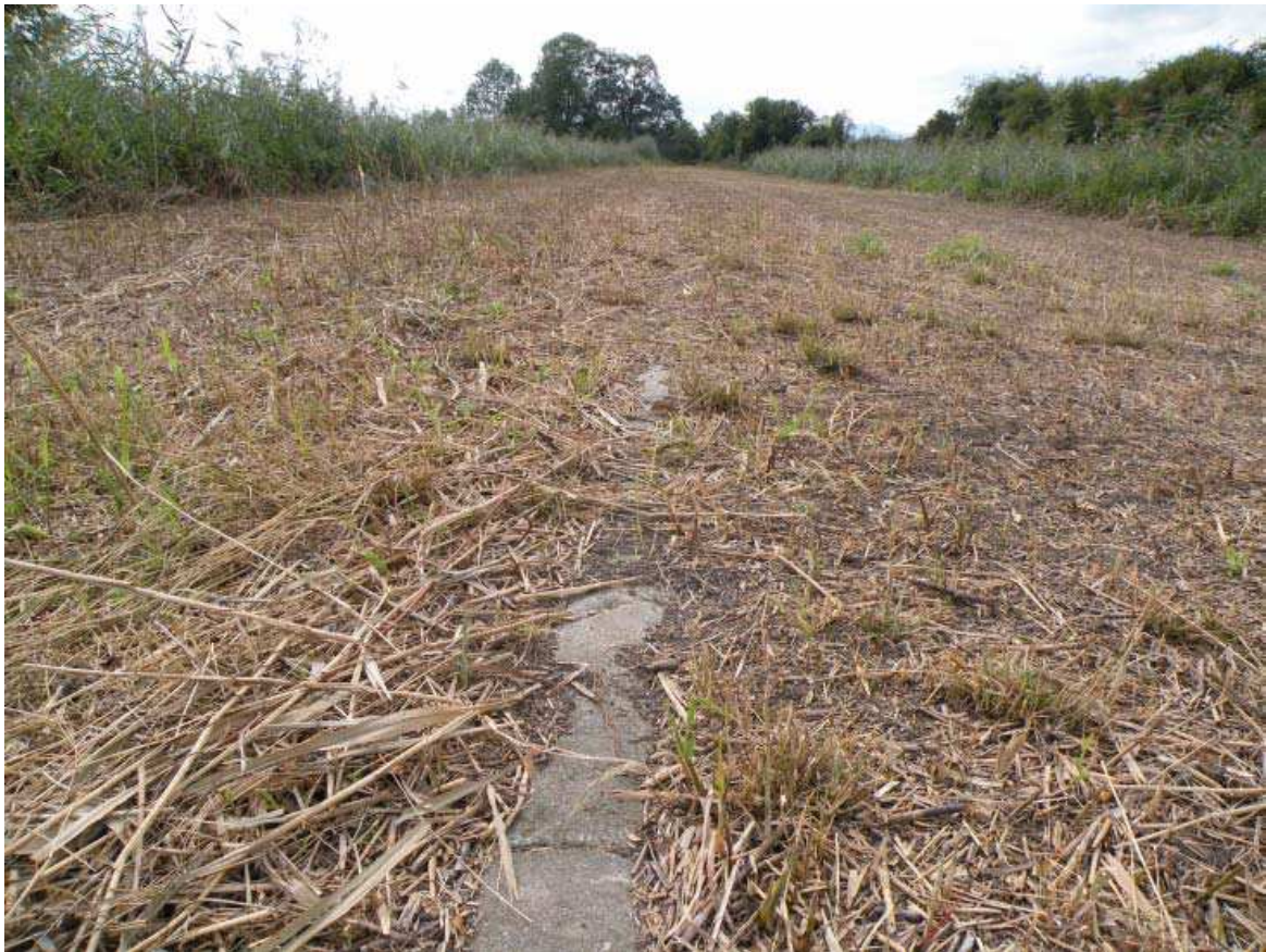
Betonrohr, unerwünschte Drainage in die Leugene.
