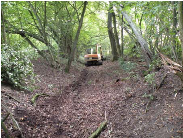
Trockenes Gerinne vor Instandstellung.
