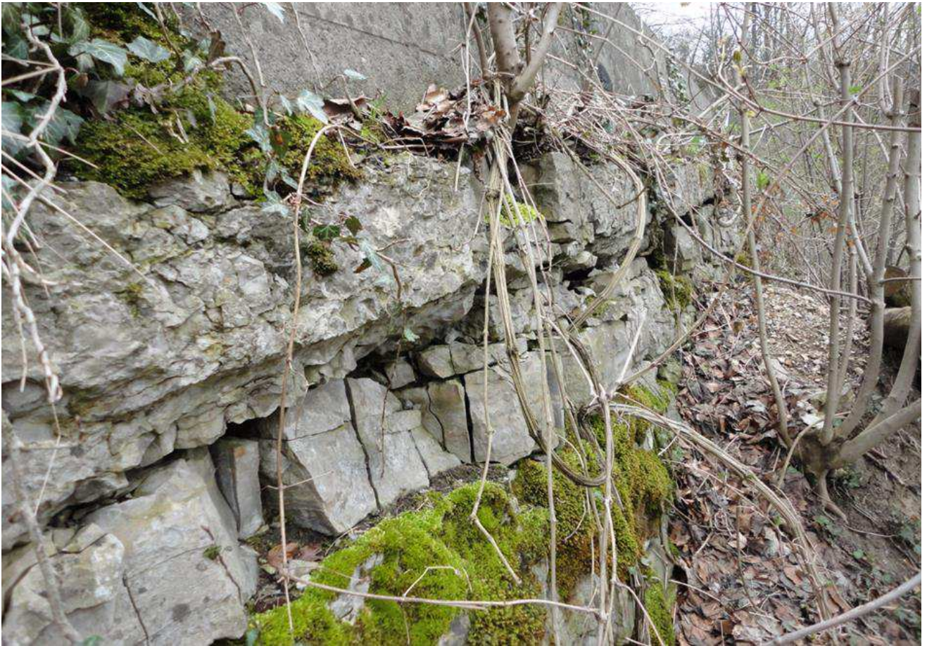
Schlechter Zustand der Natursteinmauern
