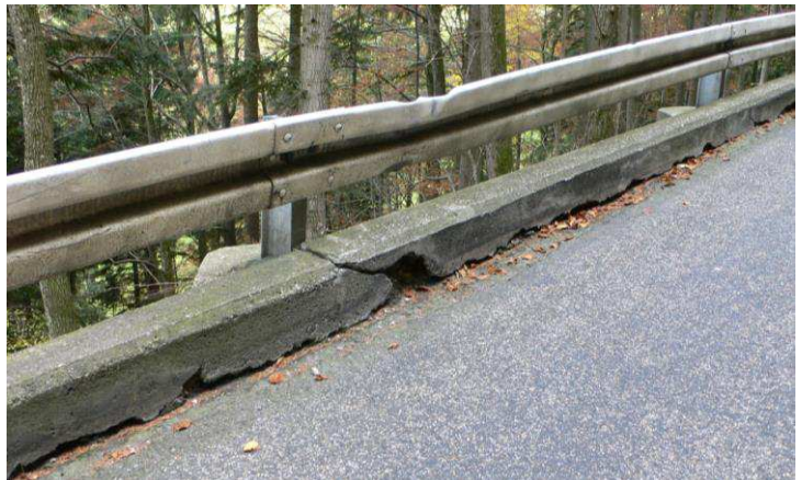
Schlechter Zustand Leiteinrichtung und Strassenabschluss
