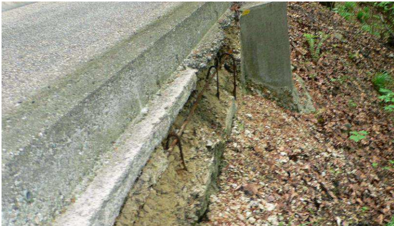
Schlechter Zustand der talseitige Stützmauer
